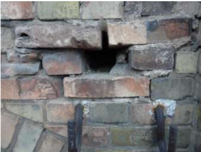
Das Mauerloch in der Fassade, vorher :
